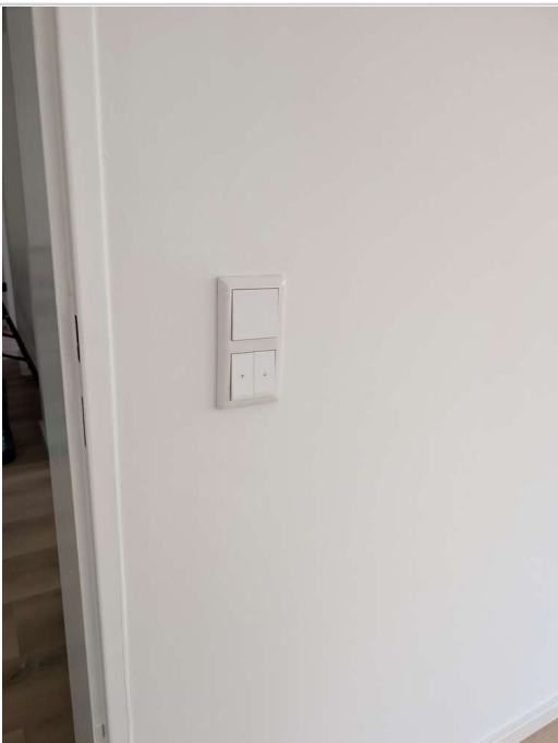
Rollladensteuerung am Eingang
